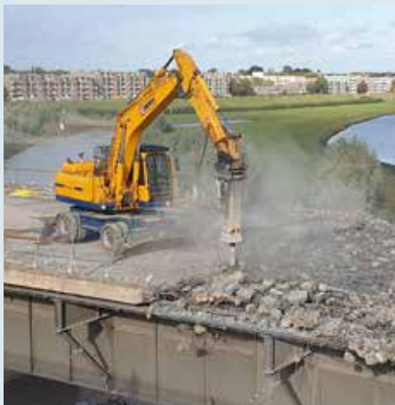
Van het wegdek is begin oktober al weinig meer over. Foto: Fons van Leusden
